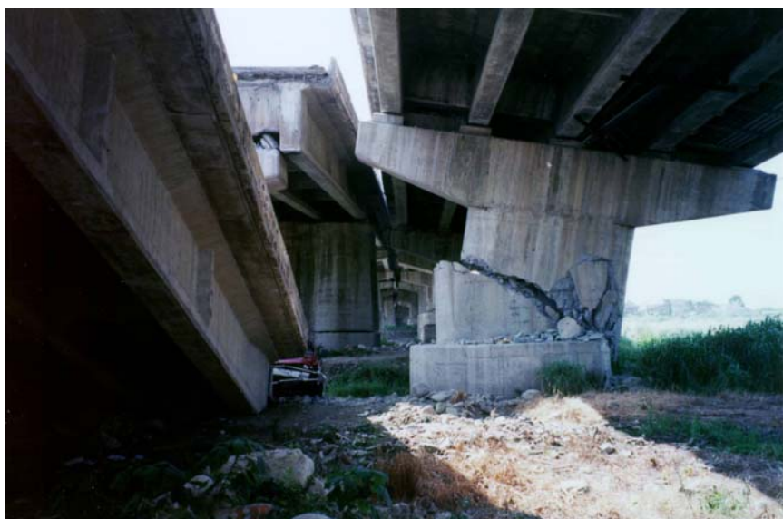
921 地震時南投草屯烏溪橋受損情形
