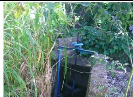
57 圳路 0k+870 鐵架分水門
