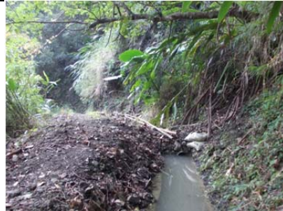
10 圳路 0k232 塑膠管暗渠
