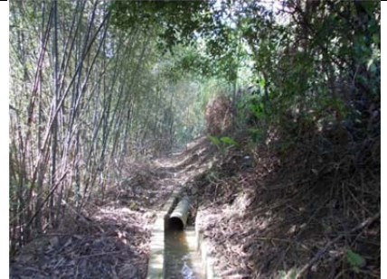
13 圳路 0k520 塑膠管暗渠
