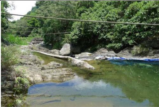
15 跨越豐南村石厝溝溪之塑膠管吊笕
