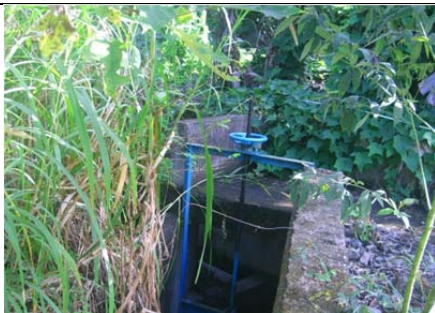
01 圳路 0k+000 鐵架分水門
