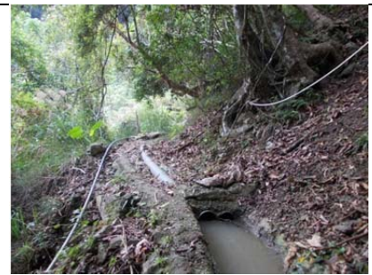
07 圳路 0k122 塑膠管暗渠
