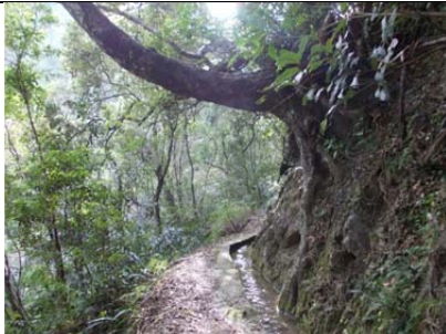
12 圳路 0k292 混凝土內面工 上有橫大樹
