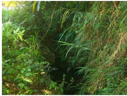
47 圳路 0k+627 塑膠管暗渠
