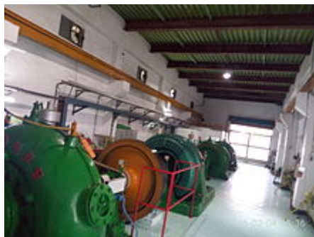
臺灣臺東縣卑南上圳小型發電廠廠房，
