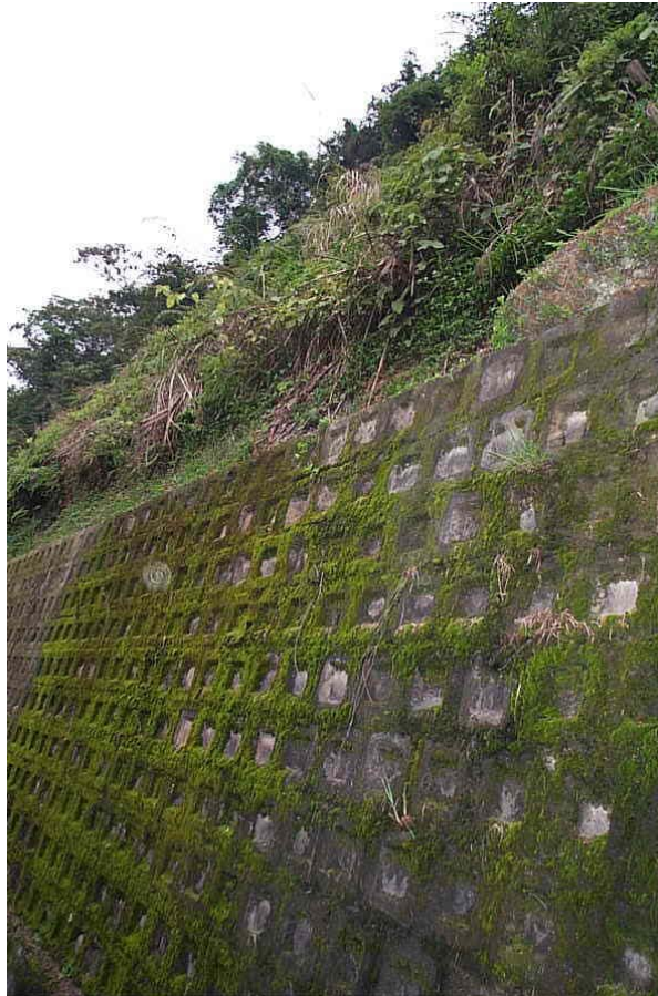
圖 3-2 背陽之擋土牆因溢流水而使潮溼牆面處長滿青苔。
