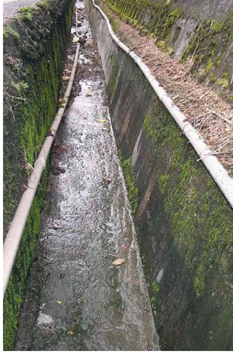
圖 3-5 排水溝側牆因潮溼表面長滿青苔。
