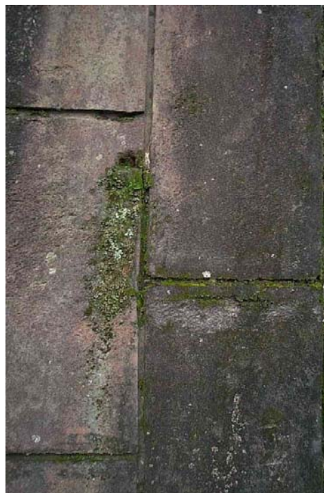
圖 3-4 擋土牆排水孔堵塞後形成潮溼表面長滿青苔。
