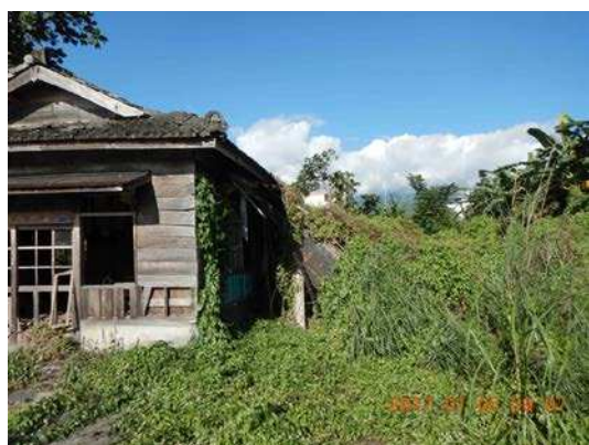
圖 189：2017 年房舍倒塌現狀
