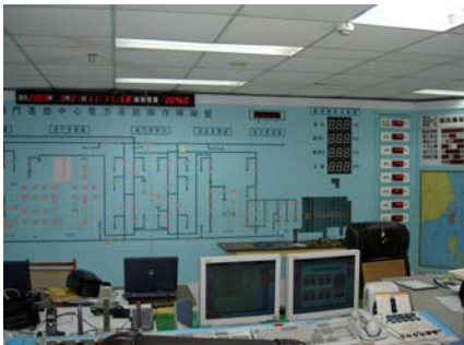
銅門廠副控中心
