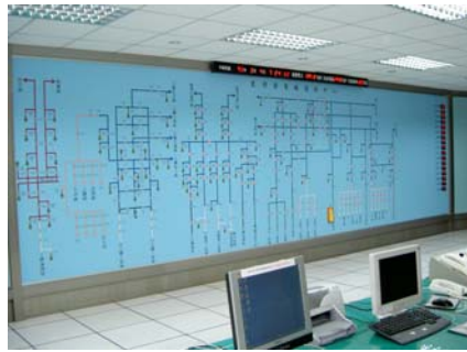
東部發電廠遙控中心
