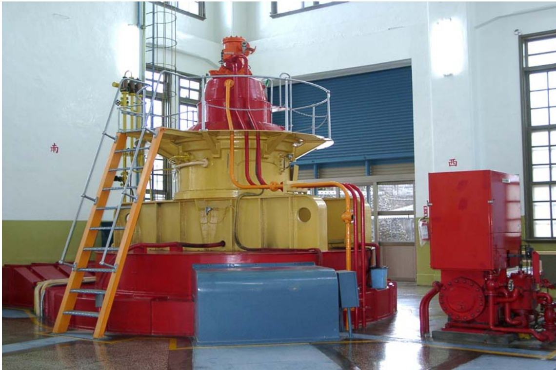
圖 3.9 豎軸式發電機組
