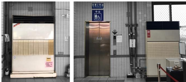
圖 3-28 空調設備與電梯
