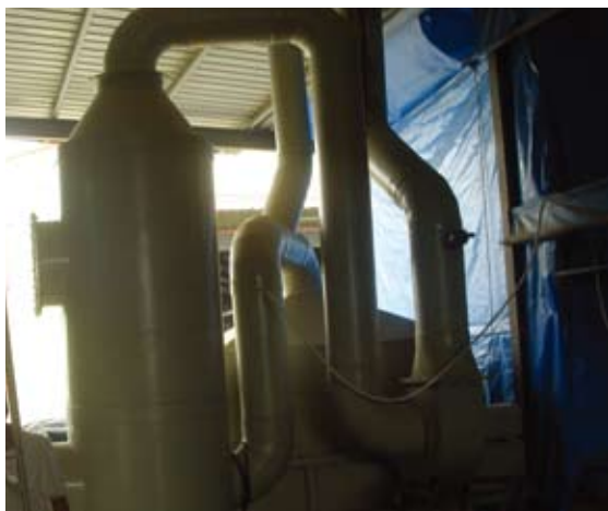
蛋雞場雞糞堆肥排氣處理系統
