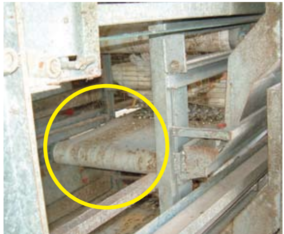
大型自動拖糞設施
