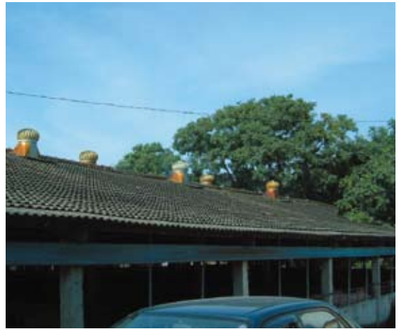
屋頂散熱裝置
