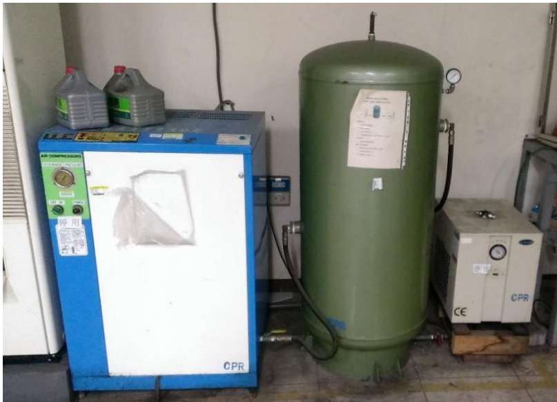
圖 3.21 進氣系統設備
