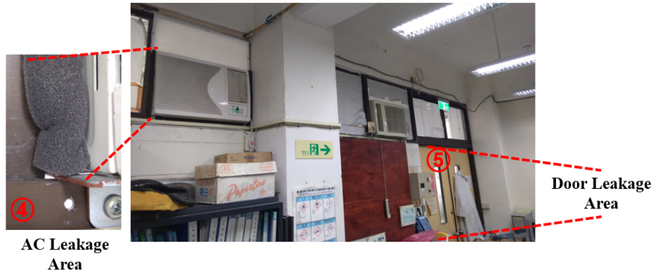
圖 5.9 本研究實驗空間冷氣裝設牆面
