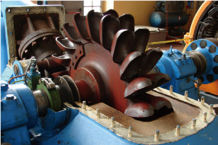
佩爾頓水輪發電機組
