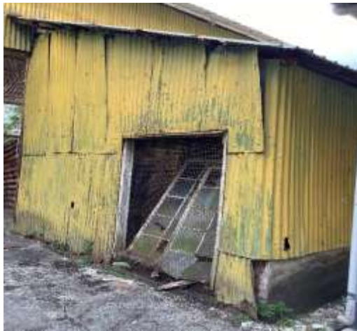
切蔗機旁房子的玻璃碎裂
