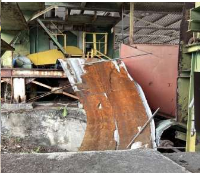
切蔗機後方鐵皮掉落
