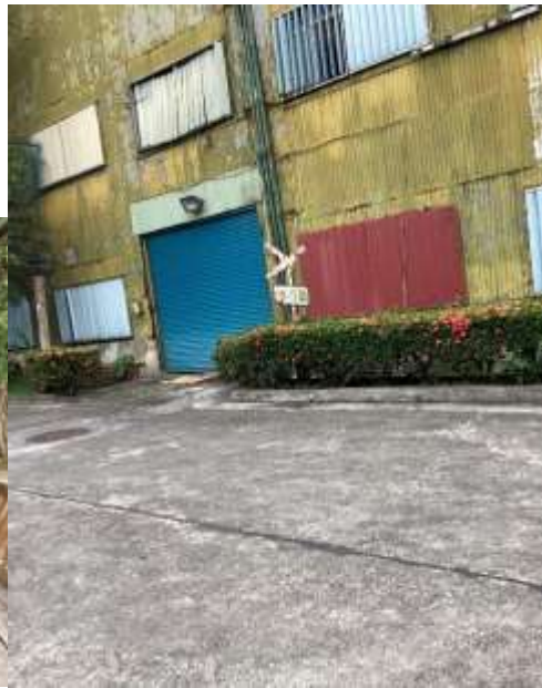
糖廠工廠的油漆剝落
