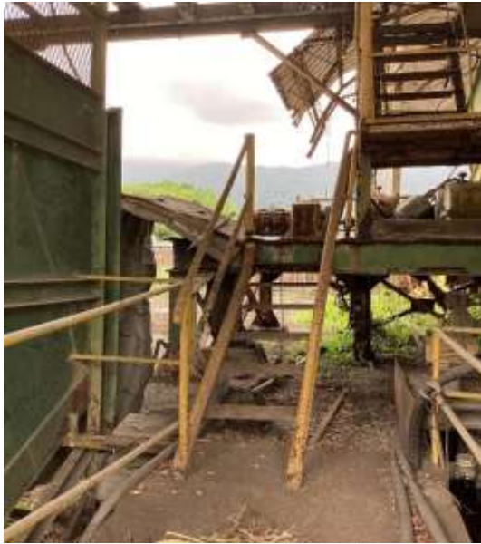
切蔗機上方的鐵皮掉落
