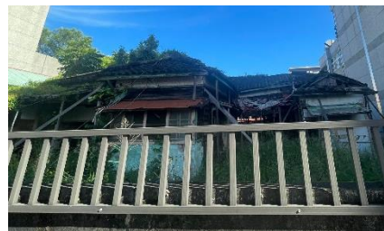
圖中為花蓮市失修建築
