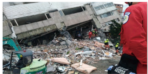
圖1 雲門翠堤大樓倒塌現場
