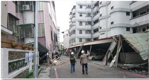
圖 4 白金雙星大樓倒塌現場
