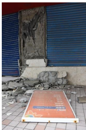
（圖九）爆開的水泥柱
