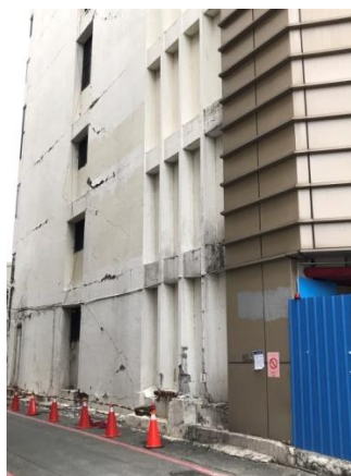
（圖十）龜裂的外牆
