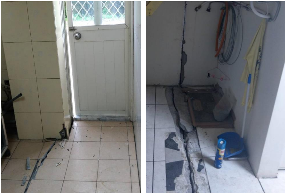
照片 2 國盛八街及五街住戶地基液化下陷，伴隨室內斷層錯動而破裂情形
