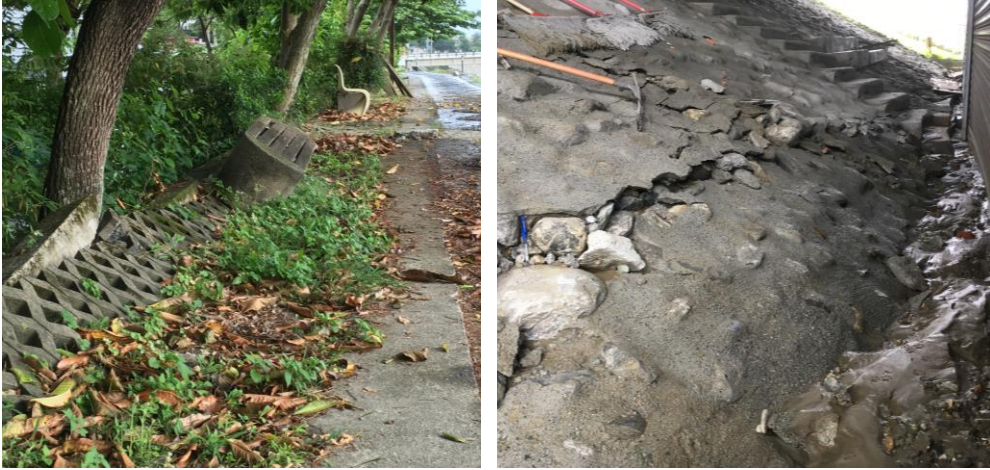
照片 9 美崙溪畔及尚志橋下堤防護岸，因液化震陷及地表破裂而損壞
