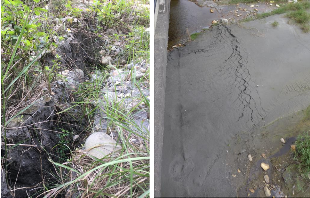
照片 11 花蓮大橋橋下附近地盤，土壤液化及側向擴展情形
