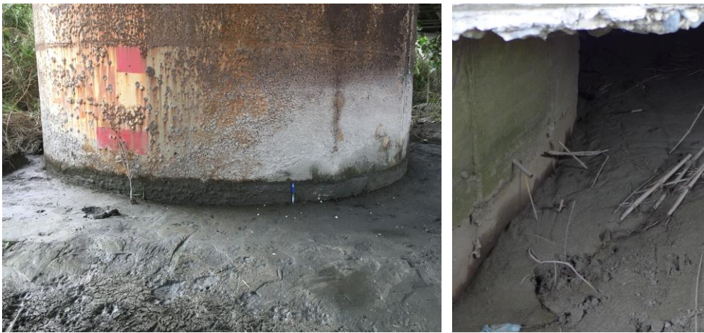
照片 10 花蓮大橋及中山橋墩柱，因樁周土壤液化下陷而引致負摩擦力
