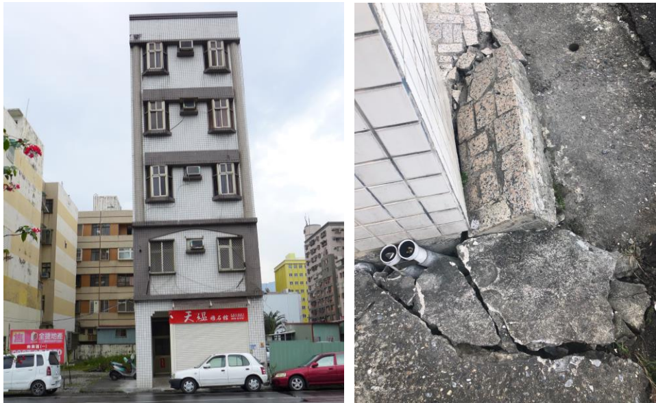
照片 4 國盛二街建物地基液化下陷，導致大樓傾斜約 1~2°，被貼紅單
