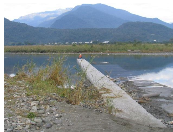
(6) 東里堤防挑流丁壩壩頭沖刷出深潭
