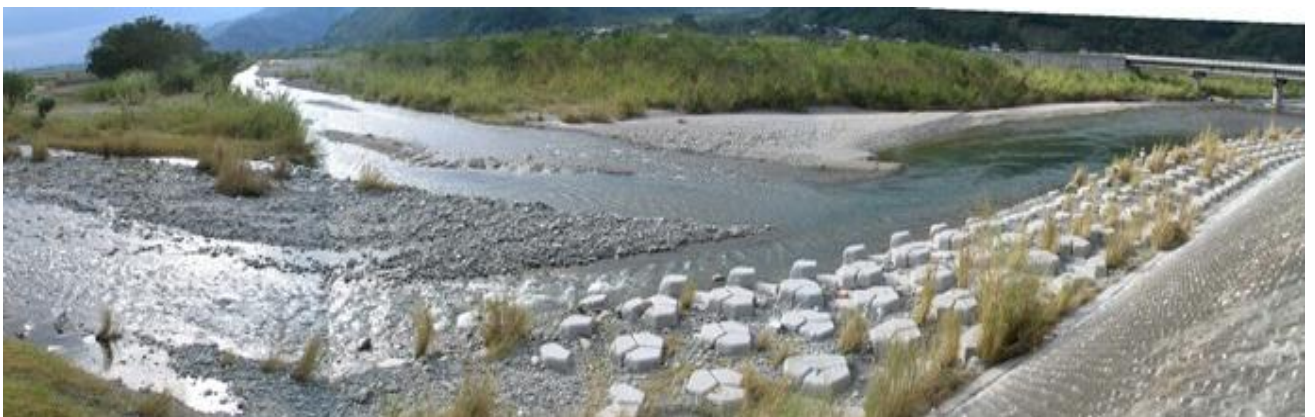
(5) 富里堤外混凝土型塊與水流對沖形成潭區 (石平橋上游) (93.12)
