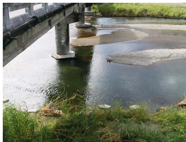
(4) 石平橋橋墩下方沖刷出深潭
