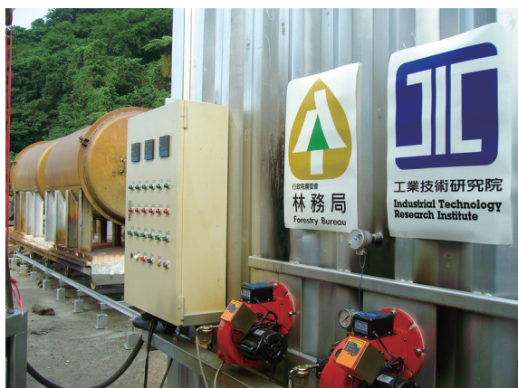
▲照片5 隧道式漂流木炭化處理設備。
