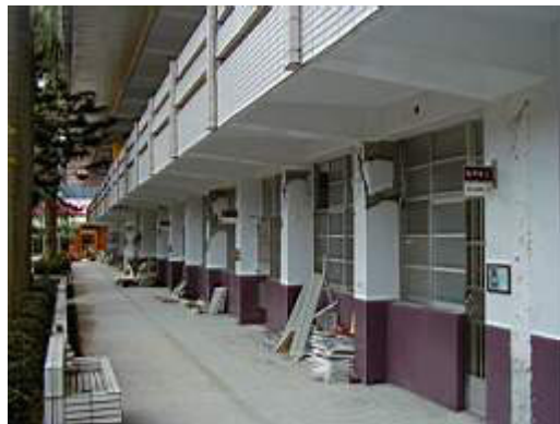
圖四 懸臂式走廊受強震柱頂端受損的情形
