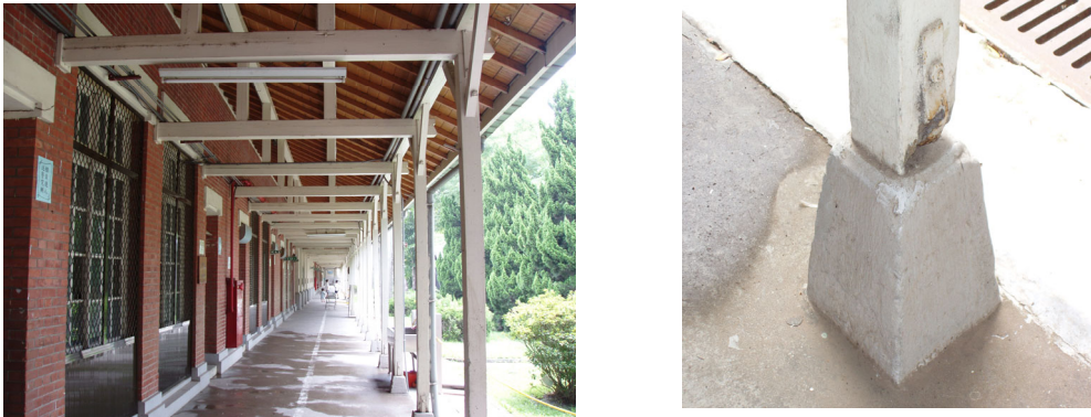
圖五 豐原市翁子國小日據時期建造教室木製廊柱歷經震災依然完好如初
