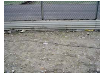
防逃設施-烤漆板
