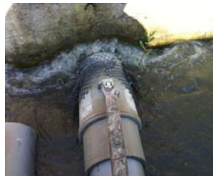
出水口防逃設施
