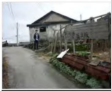
照片 1-3 面向東南，大地震前原為平 地，破裂後形成約 1.6 米落差，為方 便村人行走填土成斜坡
