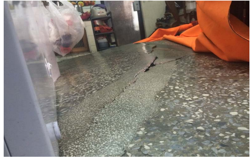
惠安里地板隆起龜裂
