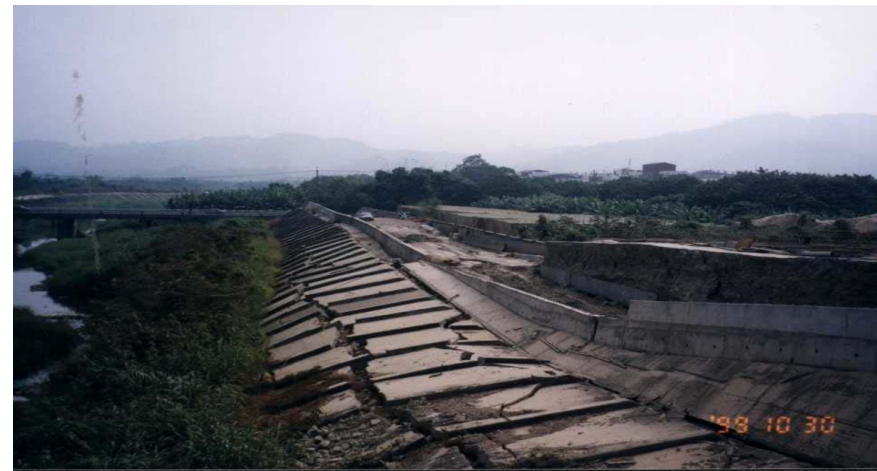
臺3線小溪橋下游左岸堤防側潰
