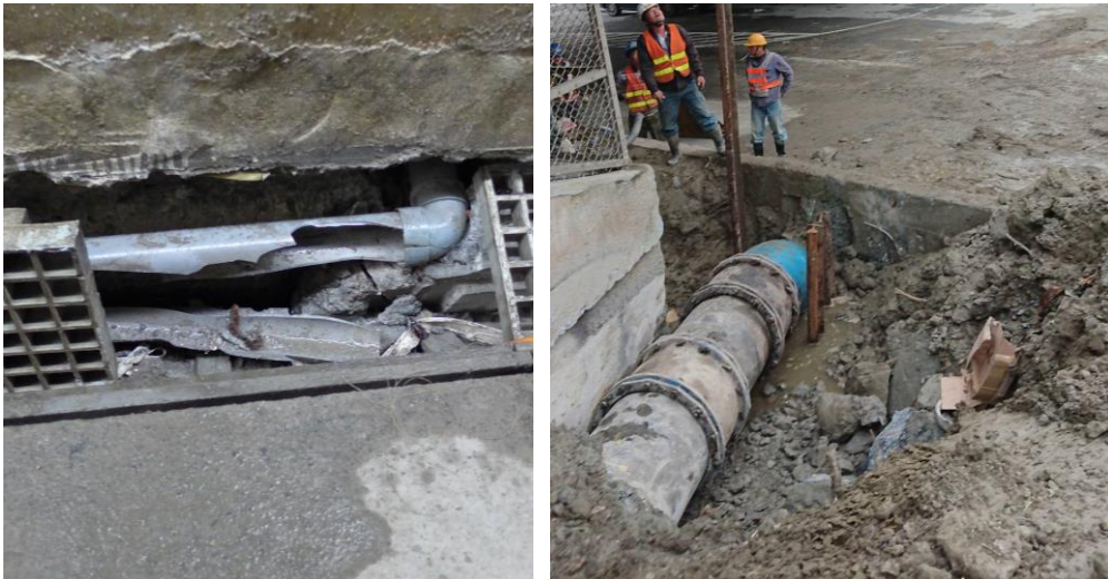
照片 8 大樓旁水溝及管線設施因液化震陷而破壞;尚志橋下輸水鋼管疑因斷層作用及路堤液化之故，導致接頭破壞而漏水
