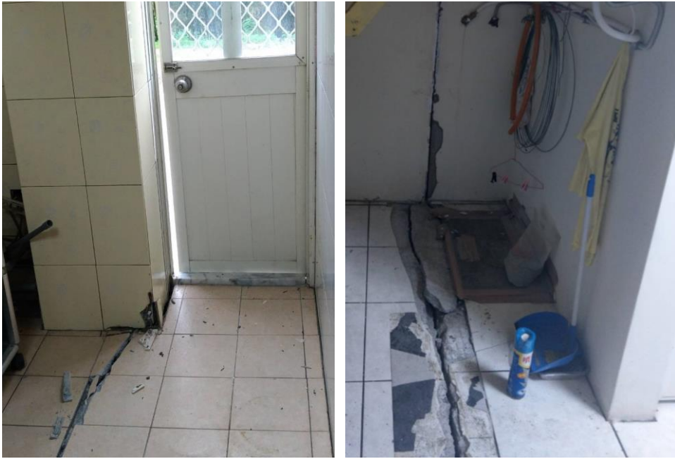
照片 2 國盛八街及五街住戶地基液化下陷，伴隨室內斷層錯動而破裂情形
