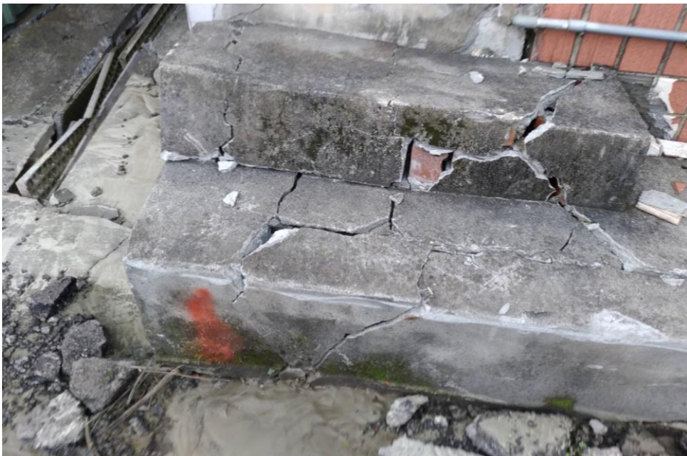
照片 1 國盛八街住戶周遭，土壤液化噴砂及一樓階梯因斷層錯動而破裂情形
