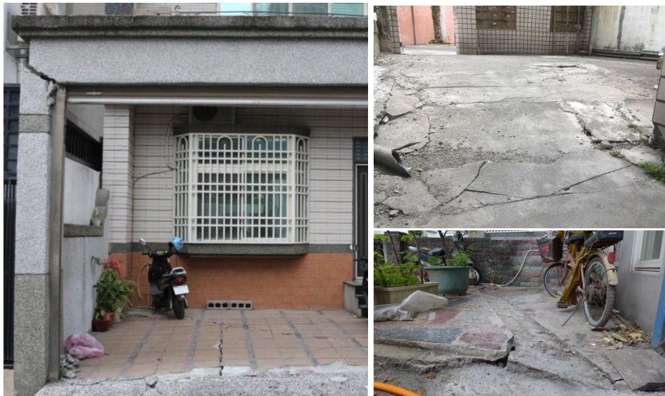
照片 3 國盛五街及六街建物地基液化下陷，高額孔隙水壓引致地板拱起、開裂
