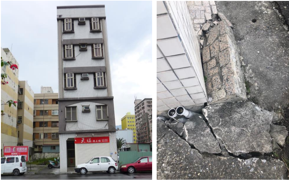
照片 4 國盛二街建物地基液化下陷，導致大樓傾斜約 1\sim 2^\circ ，被貼紅單
