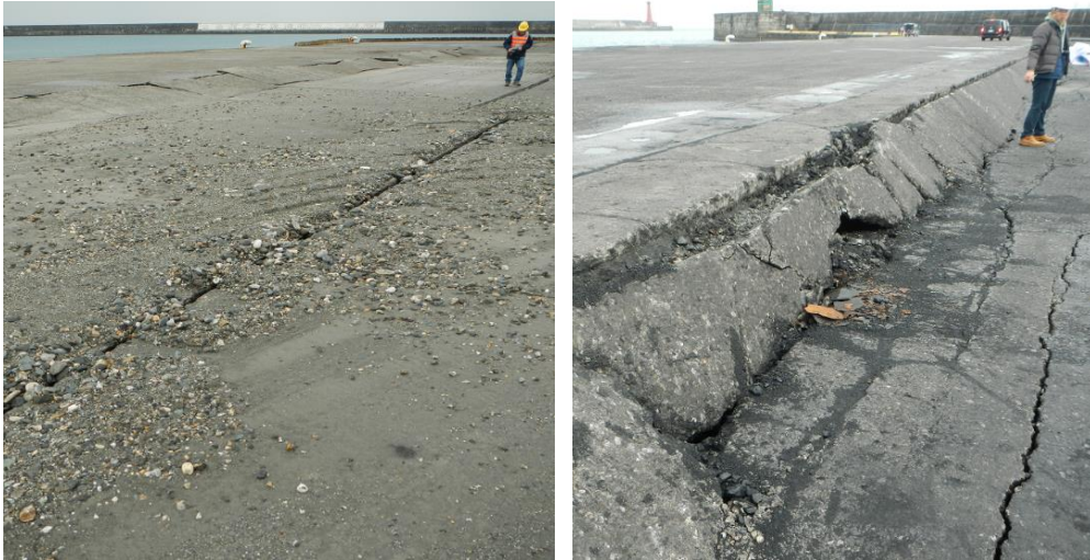
照片 7 花蓮港#24 碼頭後線礫石噴出地表；#25 碼頭後線沉陷情形(柯永彥攝)
