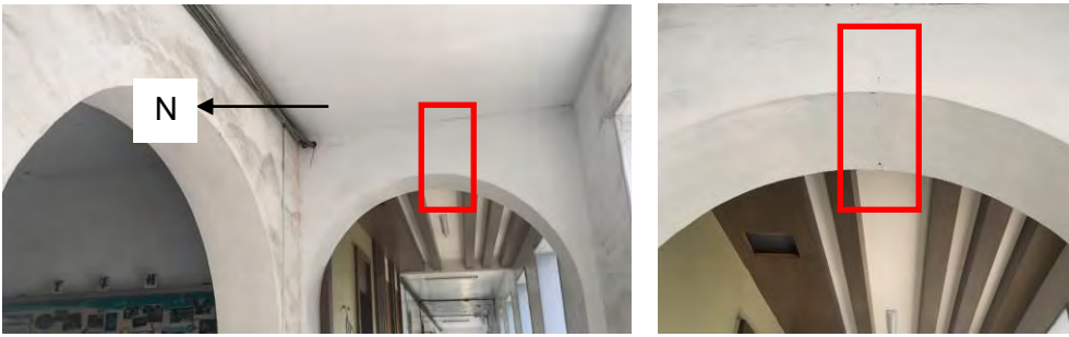
圖 29 此學校內地震後建物裂痕圖 (方框處為東西向建物，有發生裂痕)
