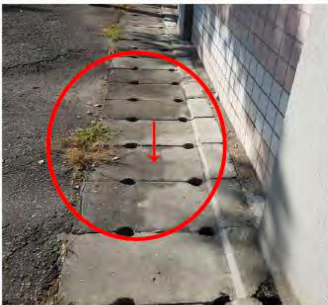
圖 1-1 台南市某國中第一棟大樓地震後土壤液化在噴砂後造成的沙漬痕跡
