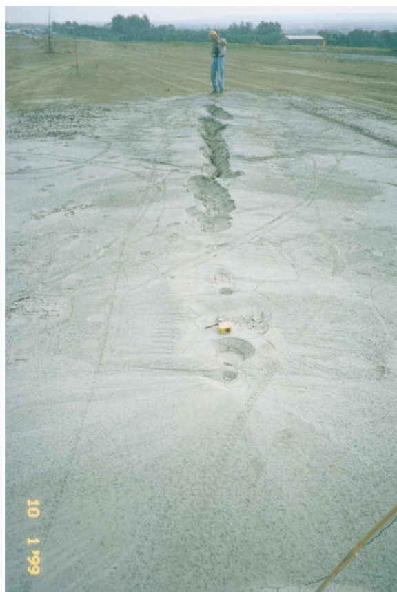
圖二 中二高名間收費站路堤開裂噴砂（王明輝攝，摘自九二一集集大地震大地工程震災調查報告）。
