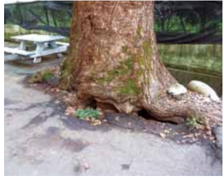
水泥車經過造成樹幹基部受傷。
