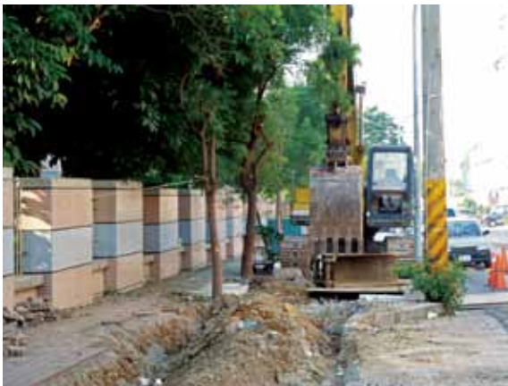
左圖是大型水管理設工程，因重機出入需求，所以修剪了許多大型樹枝，也傷害了樹木。
