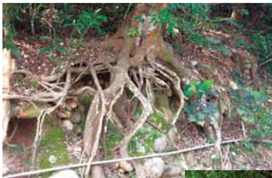
因土壤沒有保護造成樹根護土沖刷。
