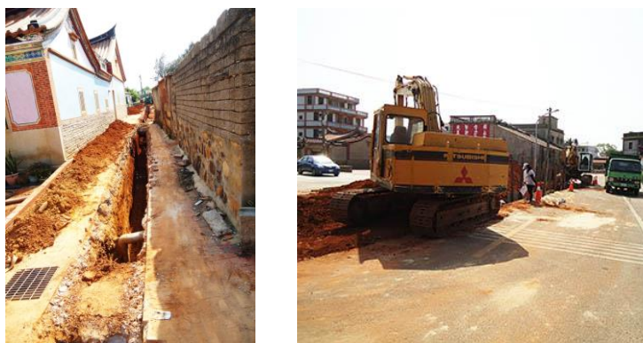
圖 4-2 施工的地點太接近建築，導致影響傳統建築的地基，使房子產生龜裂
