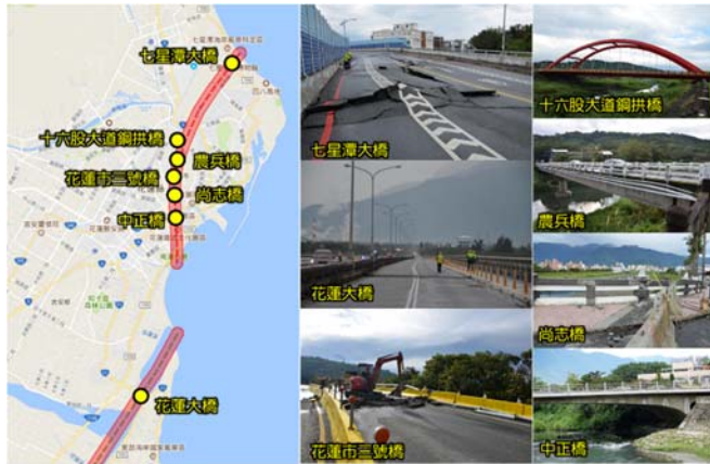
圖七 橋梁分布圖與災損情形
