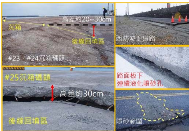
圖八 花蓮港#23 至#25 碼頭震損及鄰近西防坡堤之液化災害
