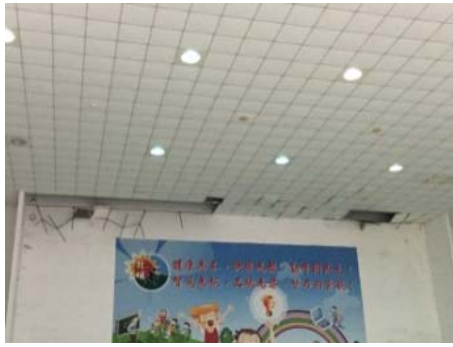
圖四 北埔國小體育館輕鋼架天花板損壞 (照片來源：姚昭智教授提供)
