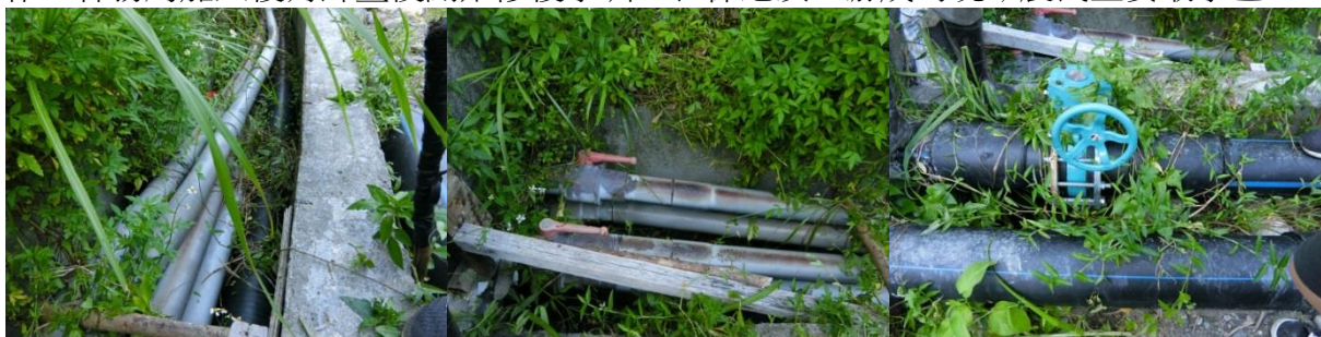
圖六：石梯坪海稻米水源管線（研究者拍攝）
