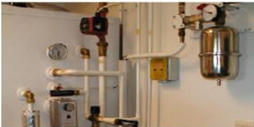
易於檢修的設備明管系統
